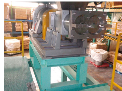
造粒 (押出) ⑨二軸混練機 [生産量]~1t/D×1台
