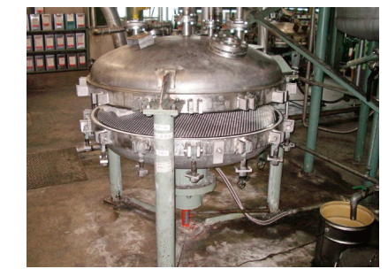
加圧式濾過機
